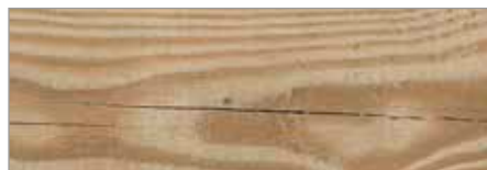
Trocknungsrisse (nach DIN zulässig)
