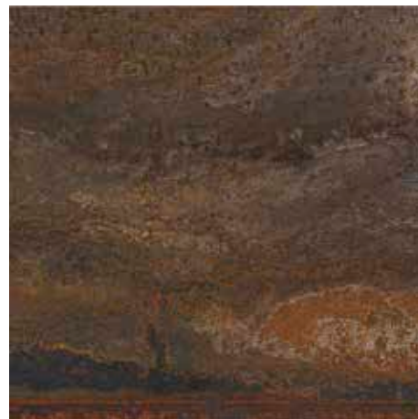
Texture vivante durant le processus de corrosion
