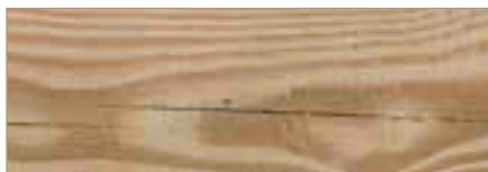
Trocknungsrisse (nach DIN zulässig)
