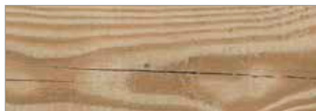
Trocknungsrisse (nach DIN zulässig)
