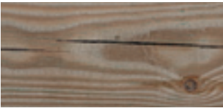
Spannungsrisse durch die Holz-trocknung
