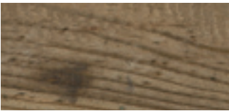
Stockflecken und leichter Schimmelbefall
